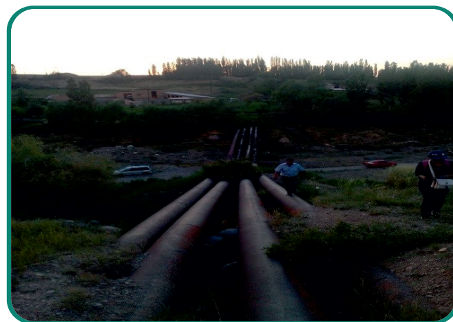
4х-ниточный трубопровод канала Бель
